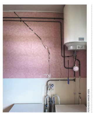
Scheuren in een boerderij in Middelstum, veroorzaakt door gasboringen.
